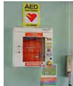
設置場所表示 (屋内)
